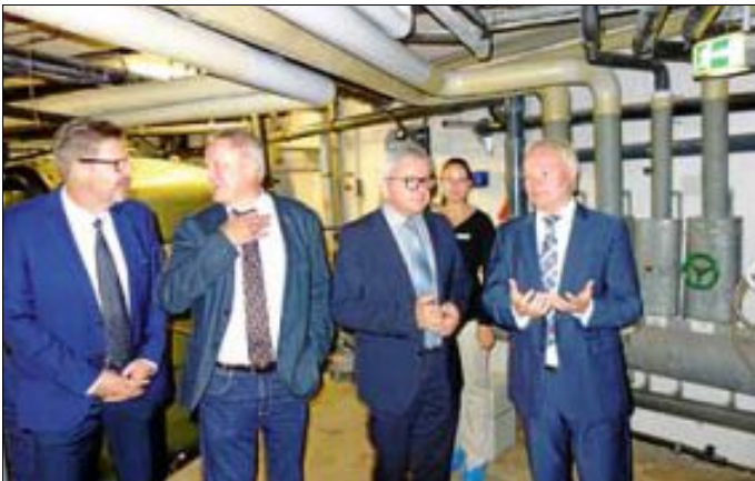
Auch hinter die Kulissen wie in den Heizungs- und Röhrenkeller der Siebentältherme schaute Minister Guido Wolf (Mitte) im Juli, begleitet von Bürgermeister-Stellvertreter Christian Romoser, MdL Thomas Blenke, Kämmerin Sabine Zenker und Bürgermeister Norbert Mai (von links). Foto: Schabert
